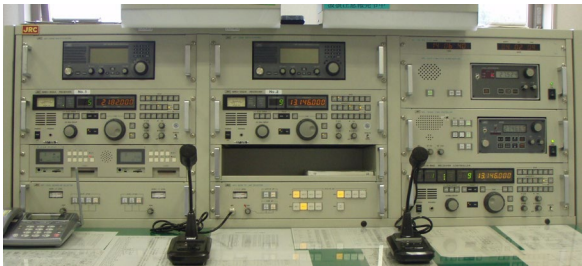
無線局舎通信室
